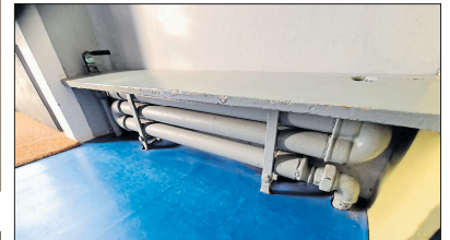
Heizungsröhre dezent unter einer Sitzbank versteckt.
